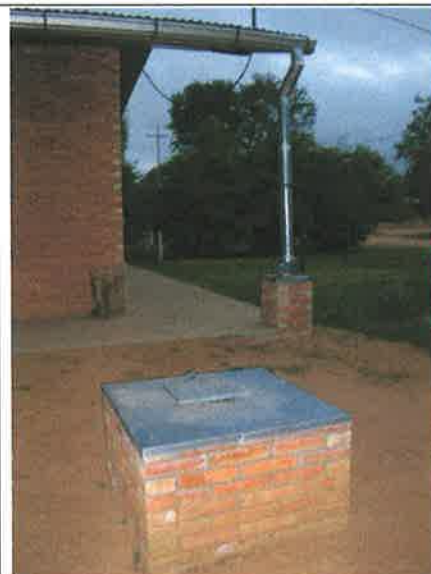
病院の貯水設備 トタン板の屋根から 樋で水を集め 地下タンクに貯める。 タンク容量は 35,000L。
